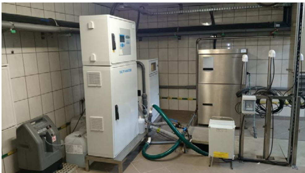
Rys. 3. Stacja monitoringu ścieków surowych
