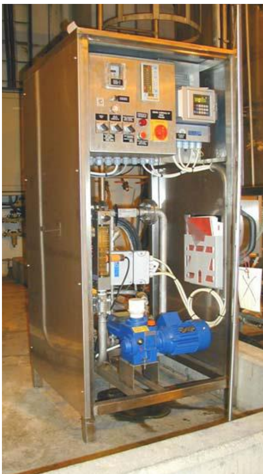
Fot. 2. stacja do przygotowywania roztworów polimerów emulsyjnych:
