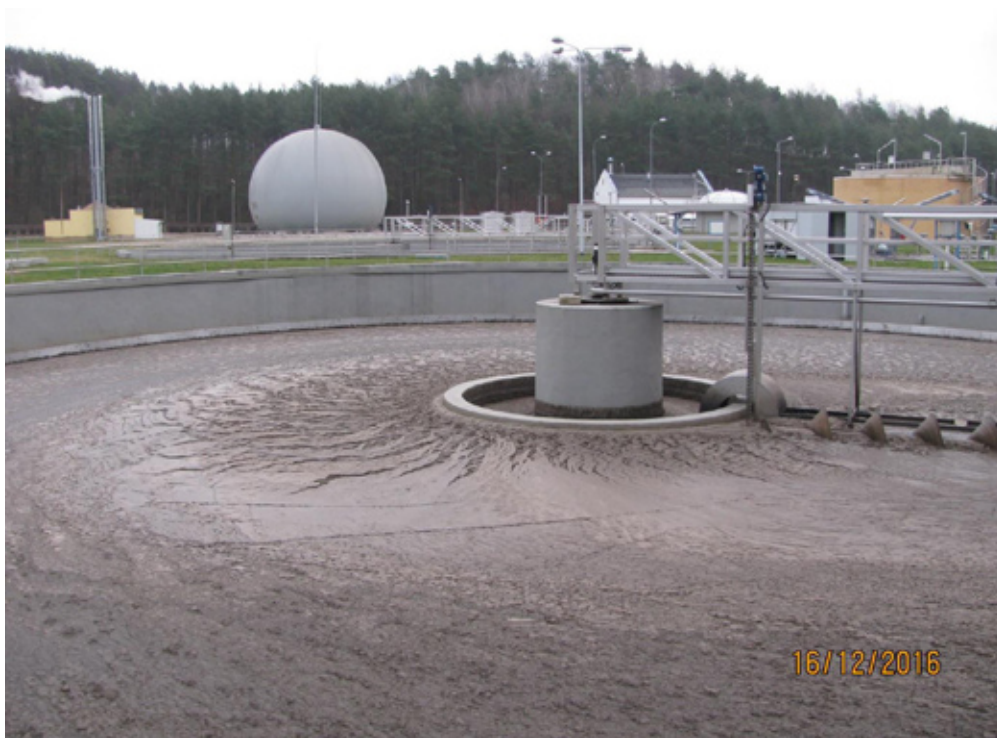
Zdjęcie 2. Przed stosowaniem PAX-18. Osadnik wtórny pokryty grubą warstwą flotu
