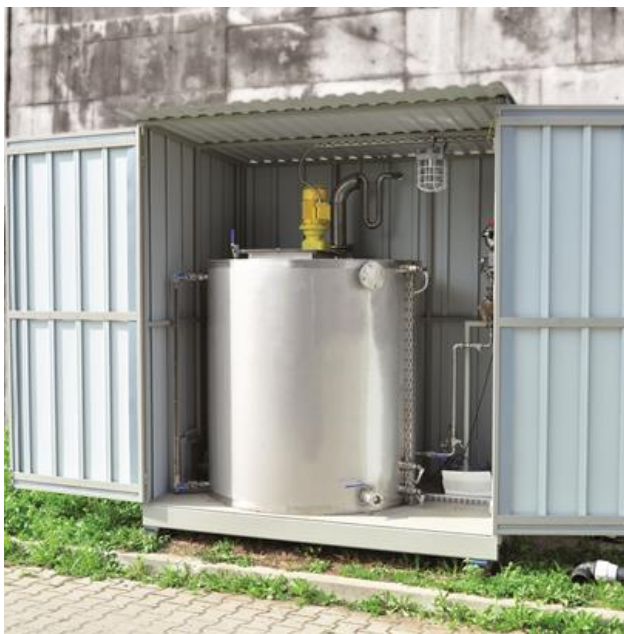
Fot. 3. Instalacja dozowania zewnętrznego źródła węgla organicznego do reaktora biologicznego (Mąkinia i in. 2013).
