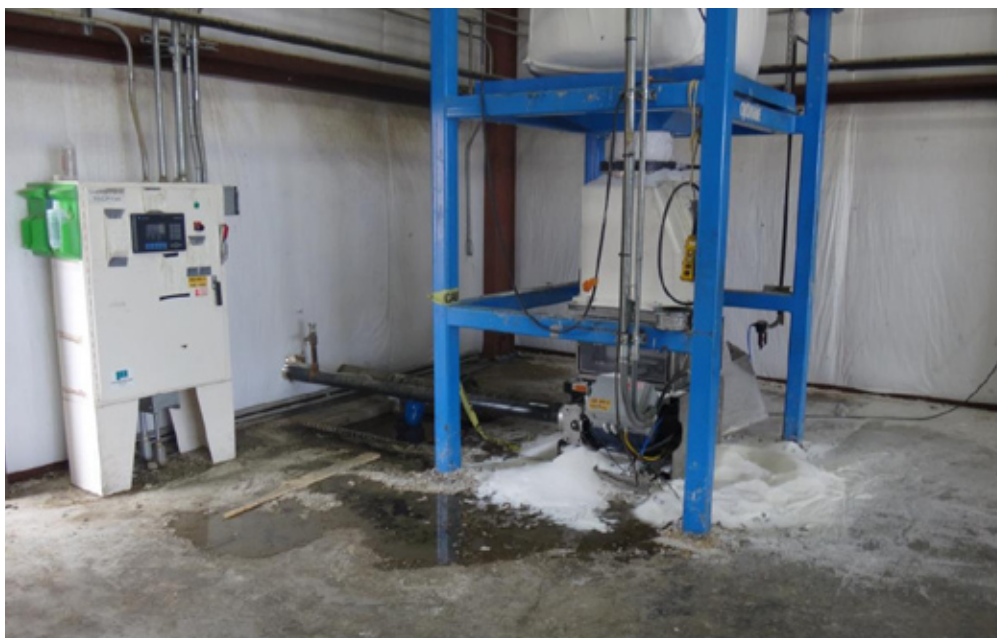
Fot. 3. Przykład rozsypania polimeru przy stacji roztwarzania
